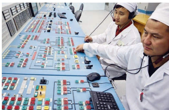
Операторы пульты газовой системы
